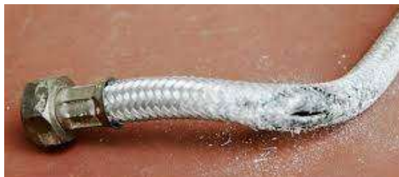
Obrázek 2 Poškození vlivem vlhka a chem. prostředků
